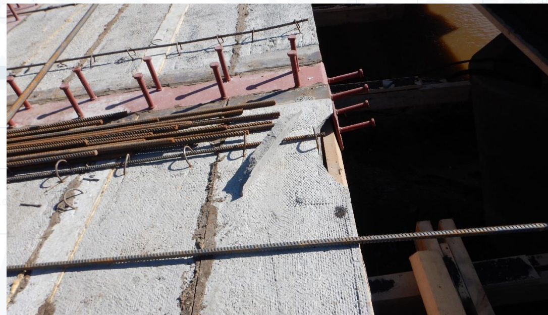
2. Необходимость ремонта сколов и трещин опалубки
