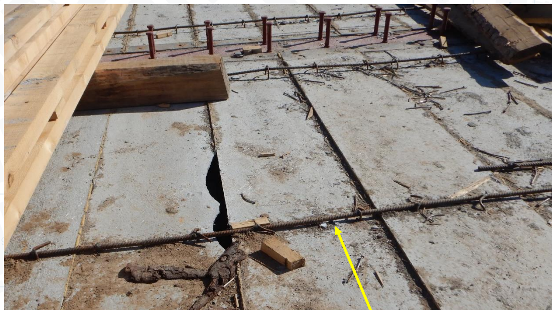
1. «Страховочные» стержни арматуры лежат на несъемной опалубке
