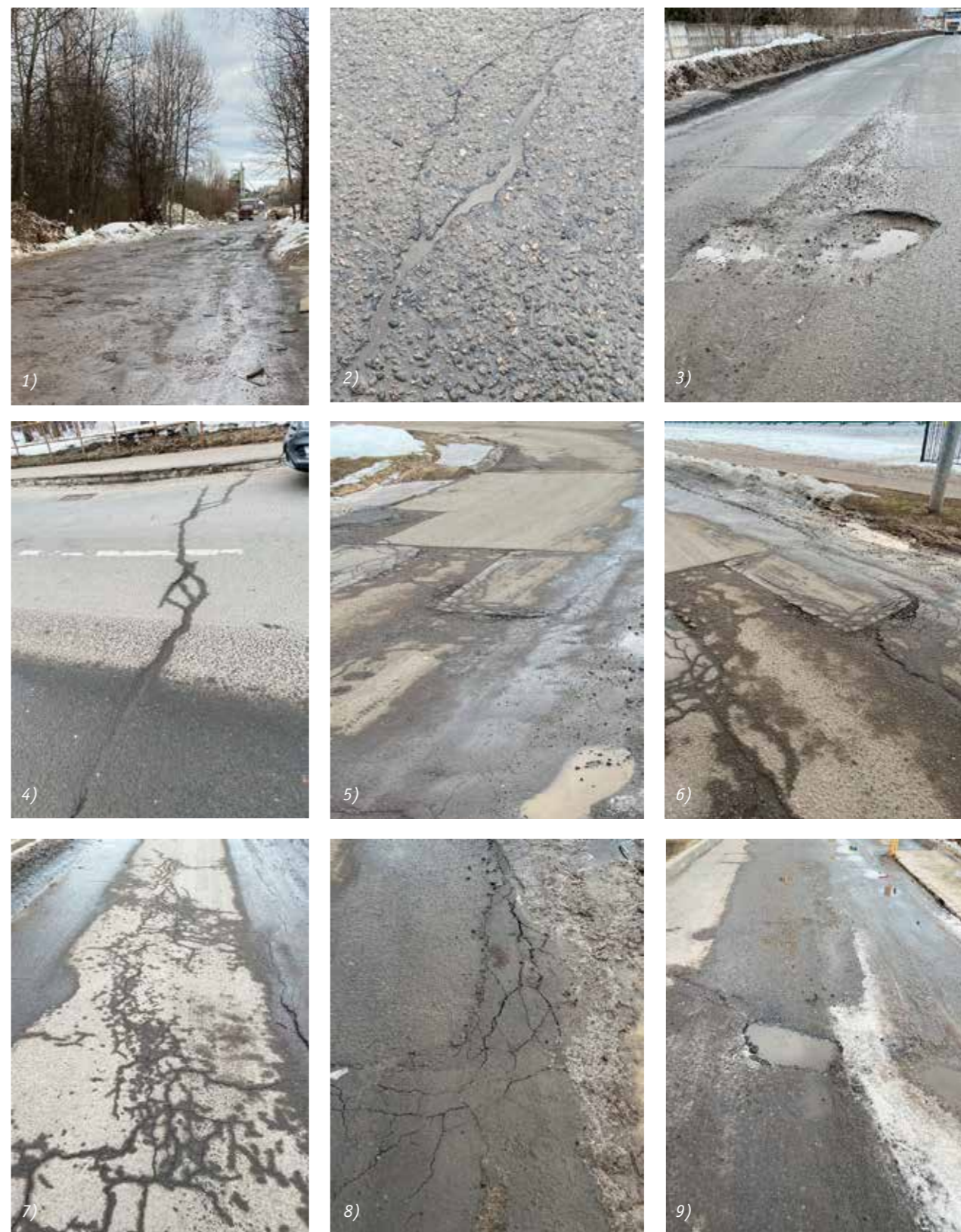
Рис. 1. Весенние деформации и разрушения дорожных покрытий на дорогах Москвы и Московской области (2022 г.):
