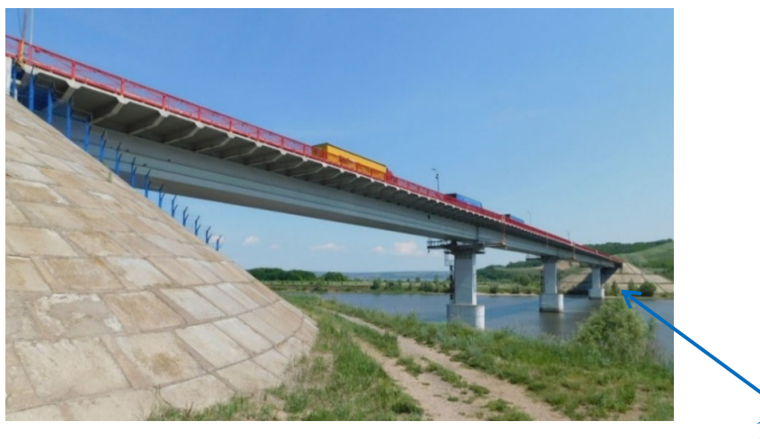
Рис. 3. Общий вид моста через р. Свяга на км 757+185 автомобильной дороги М-7 «Волга»:
