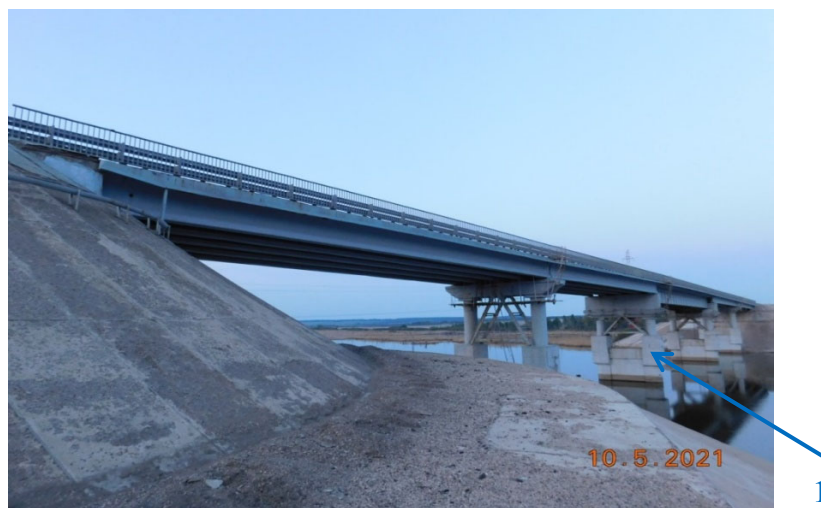
Рис. 2. Общий вид моста через р. Мензеля на км 1103+652 автомобильной дороги М-7 «Волга»: 1 – усиленные узлы объединения стоек с массивной частью после завершения ремонтных работ
