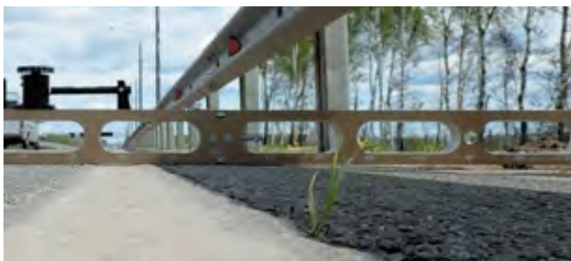
Рис. 1. Дефекты покрытия над трассой МКК
