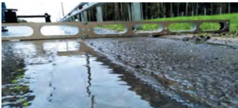
Рис. 3. Застой воды вдоль трассы ЛКС, нарушение поверхностного водоотвода
