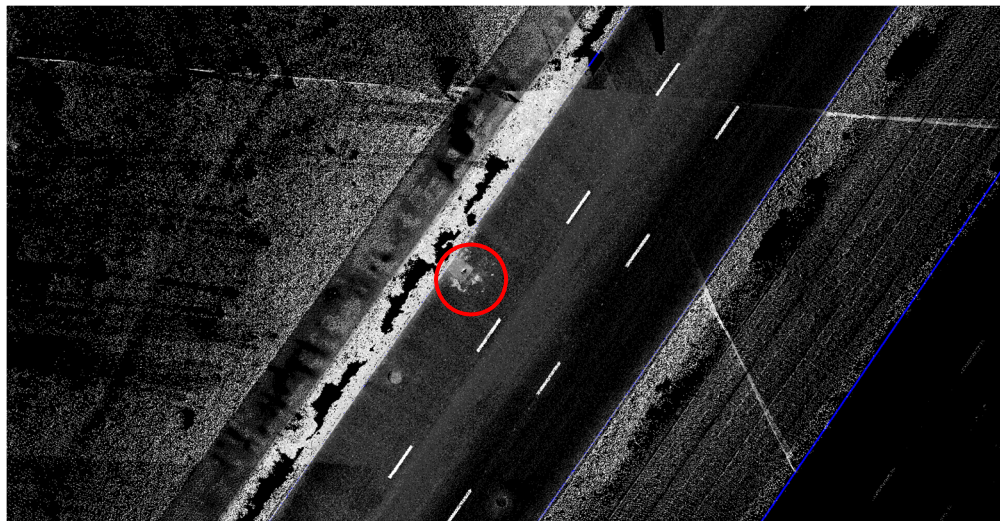
Рис. 1. Место провала дорожного покрытия в облаке точек лазерного сканирования (выделено красным маркером)
