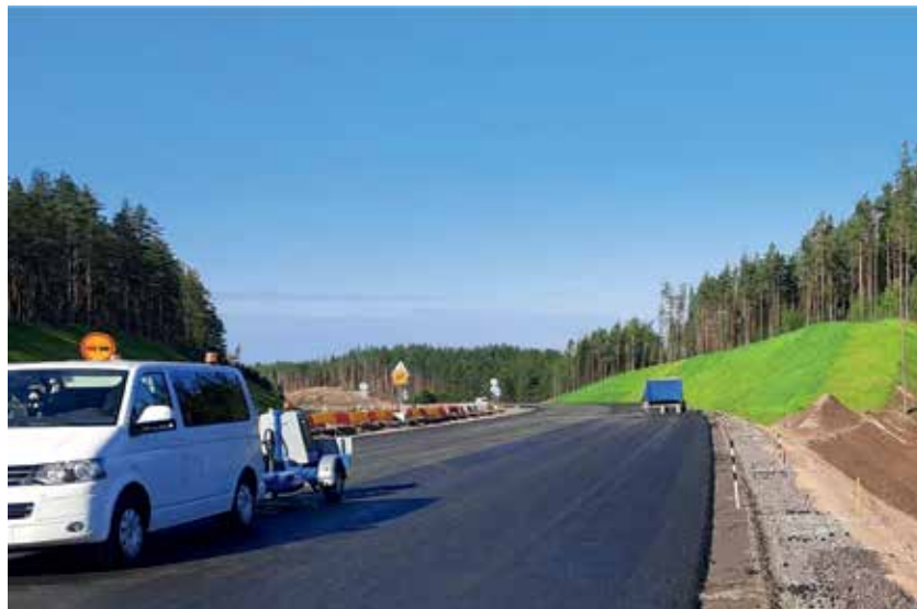
Участок дороги А-181 «Скандинавия» с использованием стальной сетки «ДОРКАРС» по технологии «САДЭМС»
