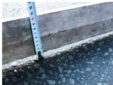
Рис. 14. Вид колеи изношенного дорожного покрытия
