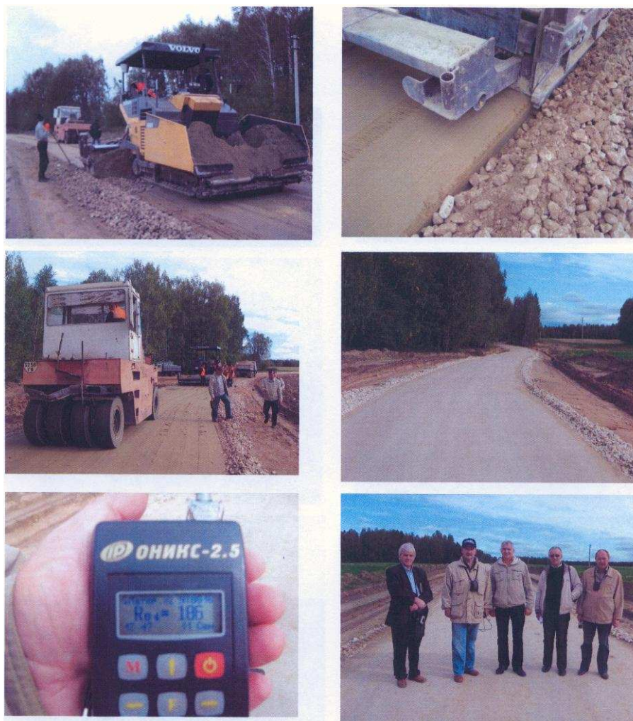
Устройство гидро-полимер-грунтового основания (июнь 2008 года) на участка а Молчаново-Мостовка II ДКЗ и 2-ой тип местности по характеру увлажнения. Ознакомление с технологией и применяемыми материалами делегацией Волгоградского управления дорог.
